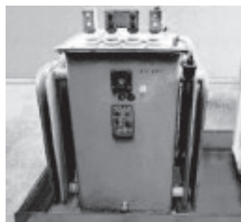
高圧トランス
