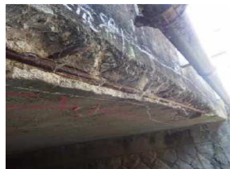
図 1.4 コンクリート橋の損傷例
