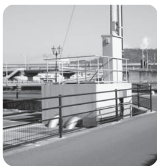
役場のポンプ場
