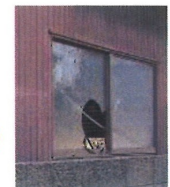
窓が割れた 管理不全空家
