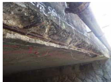
図 1.4 コンクリート橋の損傷例
