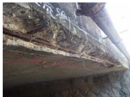
図 1.4 コンクリート橋の損傷例
