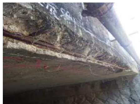
図 1.4 コンクリート橋の損傷例
