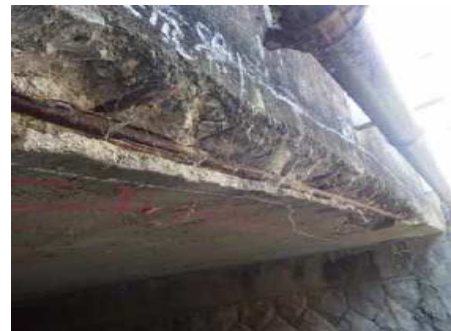
図 1.4 コンクリート橋の損傷例
